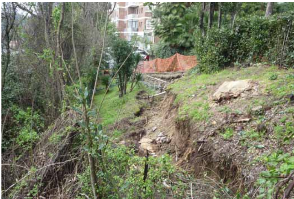
Figura 3 - Il coronamento della frana che ha lesionato la strada di accesso al condominio avvicinandosi ai palazzi
