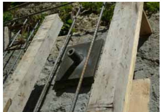
Figura 10 - Particolare della piastra di collegamento della chiodatura, poi integrata nell'armatura della cortina di rinforzo in c.a.
