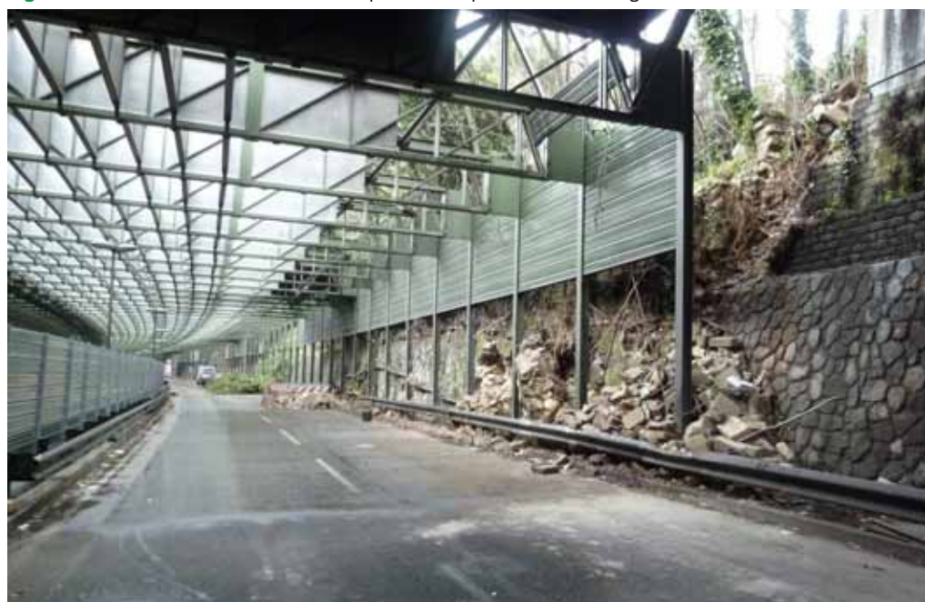
Figura 2 - Il tratto di muro di sottoscampa dell'Olimpica crollato a seguito della frana
