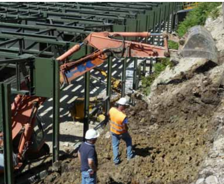
Figura 11 - Lo scavo per campioni. Si notino le difficoltà operative con escavatore operante tra i montanti della galleria
