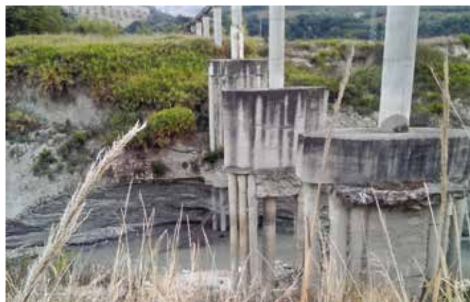
4. Un esempio di fortissima erosione fluviale del Vomano all'altezza di Castelnuovo (TE): le fondazioni originali realizzate con il palo-pila centrale furono consolidate con corona di medio-pali, oggi anch'essi completamente scoperti
