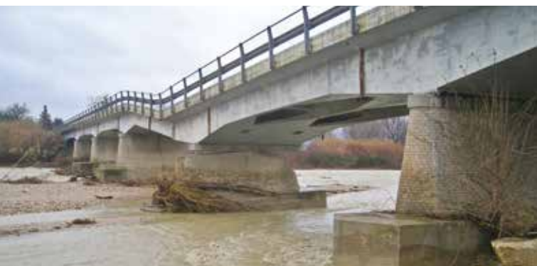
1. Il ponte del Fiastra danneggiato a seguito dell'evento alluvionale del 2011
