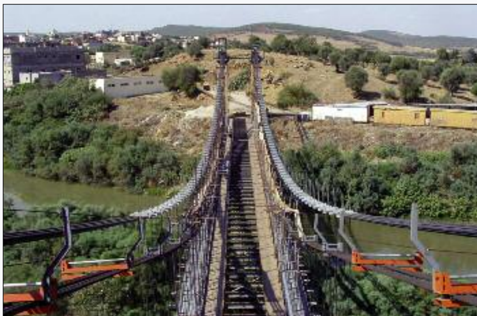
12. Un esempio di disposizione dei nuovi cavi lateralmente ai preesistenti: il ponte di Chiani
