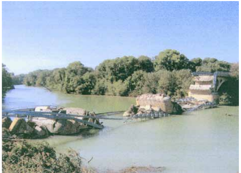
Figura 7 - Crollo del ponte sul Sangro della statale S.S. 16 "Adriatica"
