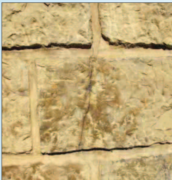
Рис. 7. Трещины раскалывания на теле промежуточной опоры
