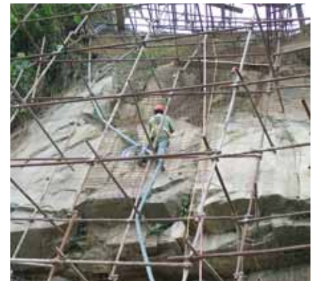
Foto 22 e 23 - Gli interventi di chiodatura del bancone di arenaria della spalla nord
