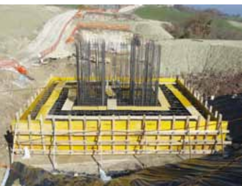
Figura 21 - Casseratura del plinto; sullo sfondo i tubi di alluminio lasciati per il successivo collegamento al palo sottoposto a prova
