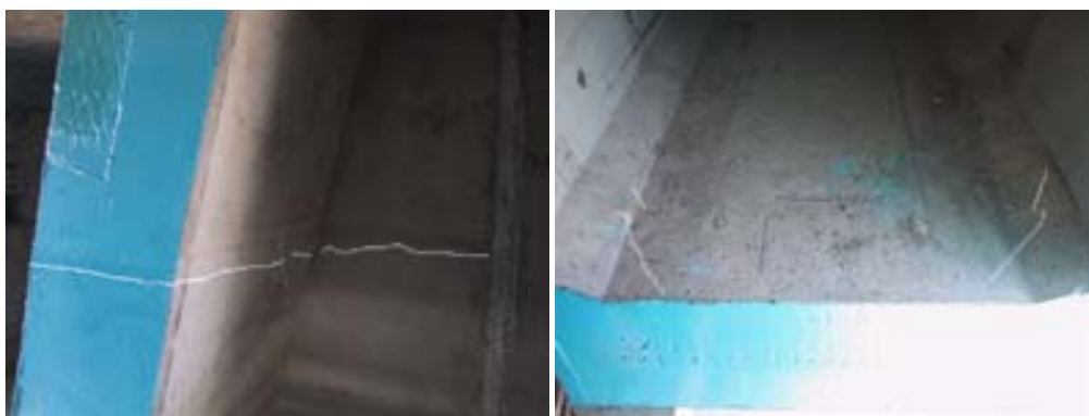
FOTO 1 - TIPICA FESSURAZIONE IN TESTATA DI CASSONCINO FERROVIARIO
